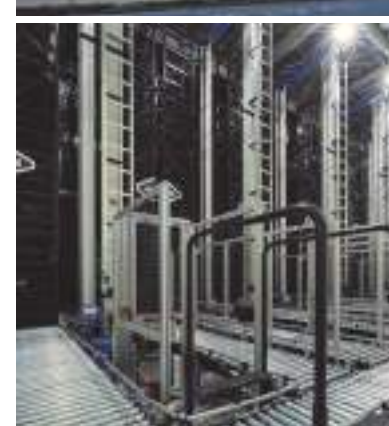
ケニス門真ディストリビューションセンター 新しい物流センターでは自動倉庫とハンディターミナル を導入し、これまで以上に効率的な入出庫が可能とな った。これにより、1万点を超えるアイテムを適切に 在庫管理し、迅速かつ正確に顧客に届ける体制を整備。 新しい基幹システムも導入し、見積もりや受注業務だ けではなく、商品管理の効率化も図る。現状の稼働率 はまだ余裕があるため、今後さらに商品数が増えても 十分に対応できるようになっている。
